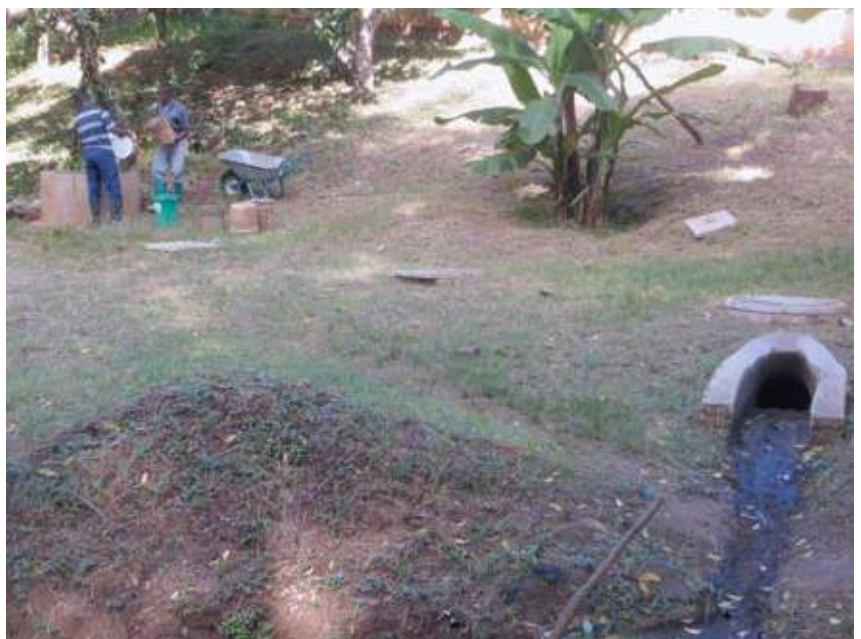
Zwei Novizen befüllen die Biogasanlage mit Mist. Die Gaskammern liegen unterirdisch, rechts vorne der Auslauf für die Überreste, die zur Gartendüngung dienen
