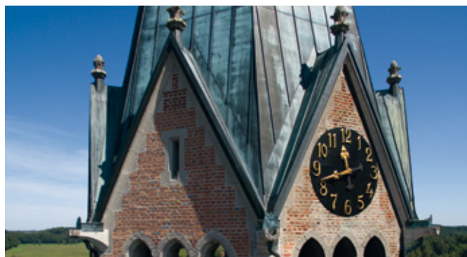
Die Kupferblechdeckung der Turmspitze ist schadhaft, sodass eine Erneuerung notwendig ist.
