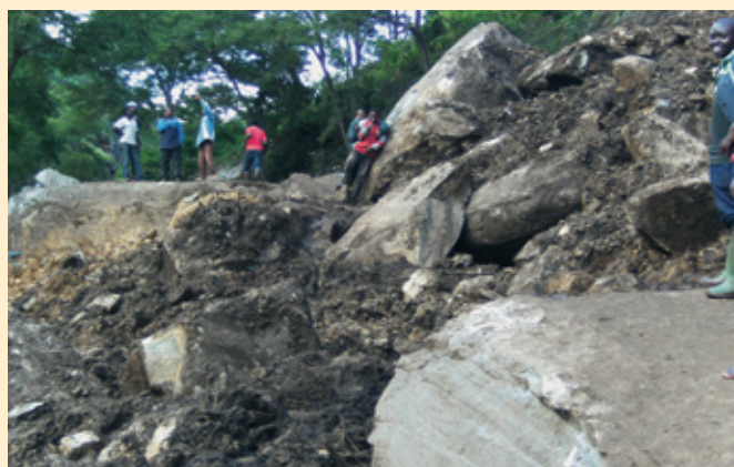
Von der Straße ist an dieser Stelle nichts mehr übrig geblieben
