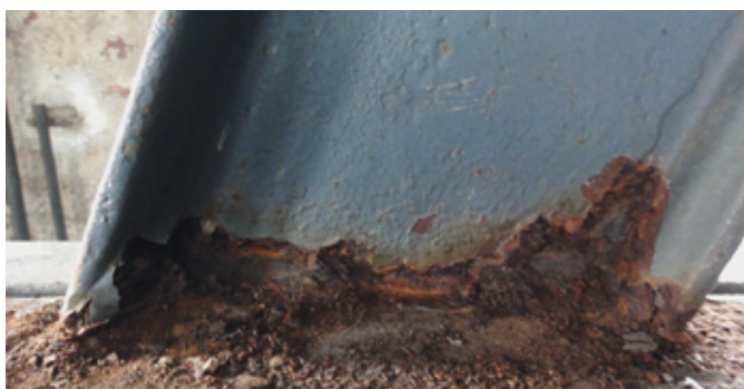
Der Fuß des eisernen Glockenstuhls ist so weit korrodiert, dass er sich von einem Schraubenzieher durchbohren lässt. Ein neuer Glockenstuhl wird benötigt.
