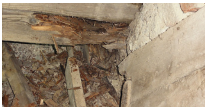
Die Dachstühle von Langhaus, Chor, Süd- und Nordquerhaus sind durch das Eindringen von Feuchtigkeit an einigen Stellen morsch geworden.
