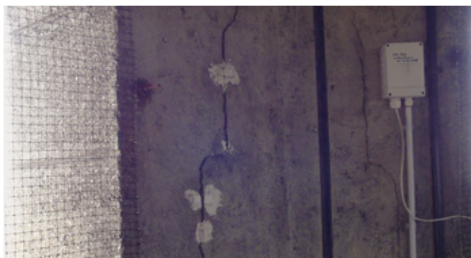
Das Mauerwerk des Turms weist Risse und Feuchteschäden auf und muss saniert werden.
